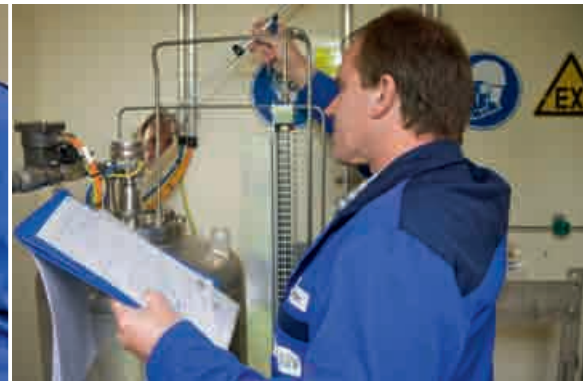
Die modernisierte Odorieranlage in der Gas-Übergabestation Taunusstein-Wehen wird von einem unabhängigen Prüfer einer eingehenden Untersuchung unterzogen.
