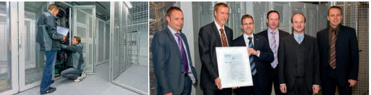
Das neue WiTCOM-Rechenzentrum DataCenter 1 wurde vom TÜV Rheinland im September 2010 mit dem Zertifikat „Secure Data Center“ für IT-Sicherheit ausgezeichnet.
