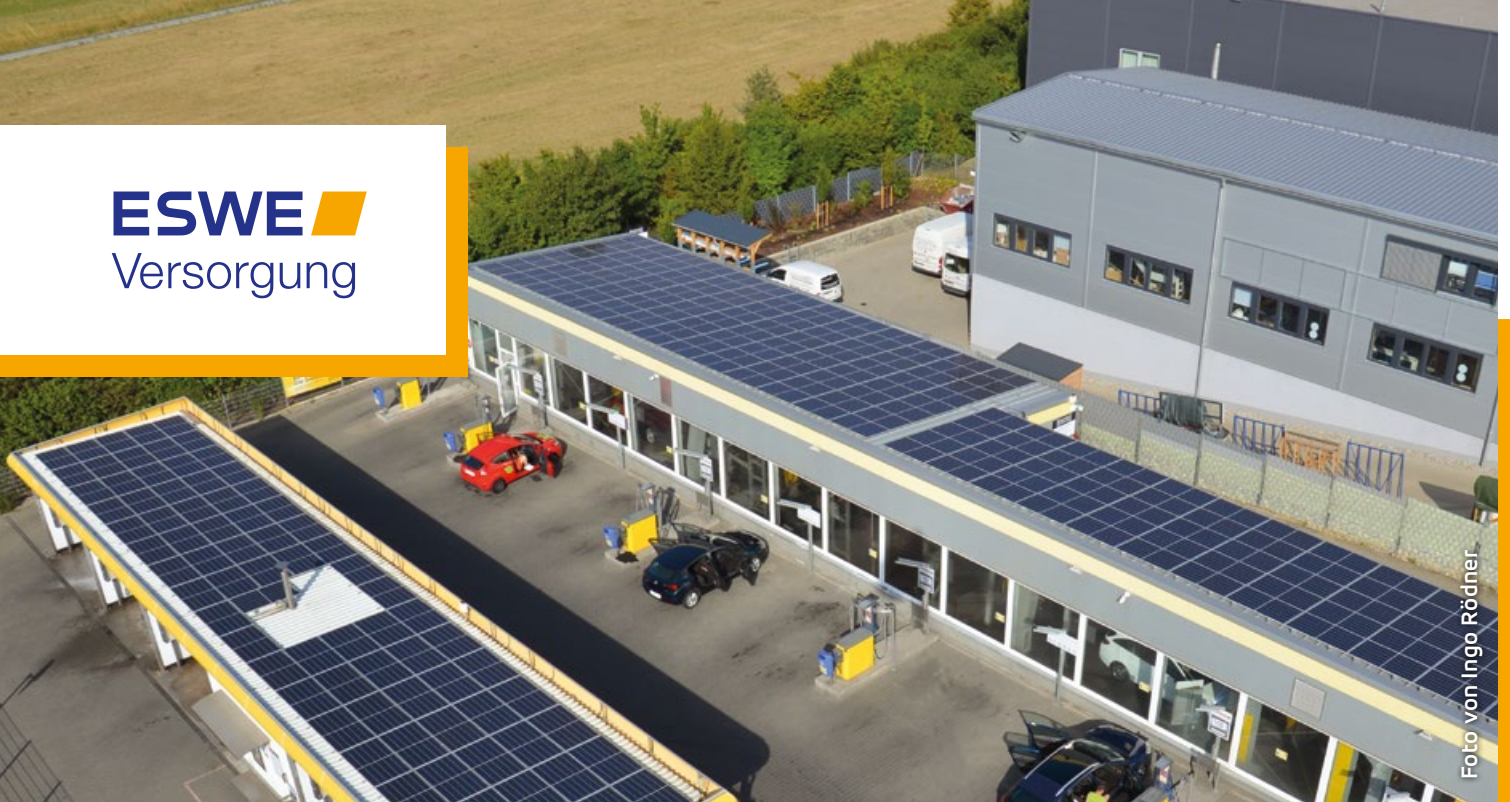
Die Waschanlage Kelkheim mit der neuen Photovoltaikanlage
