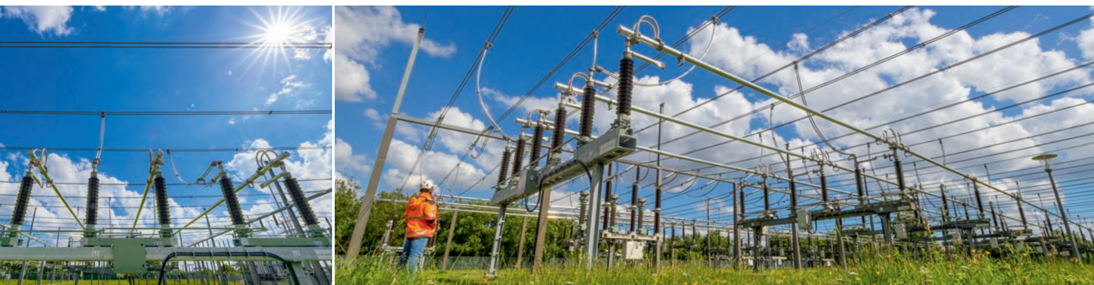
Begutachtung des ertüchtigten Reservefeldes im Umspannwerk Wiesbaden-Schierstein.
