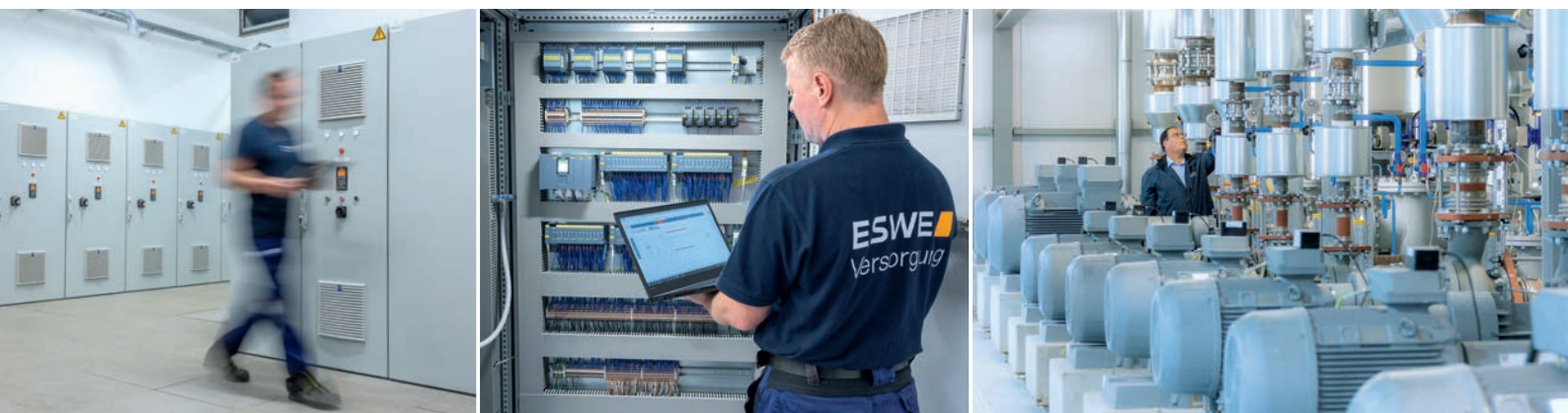
Im der neuen Fernwärme-Pumpstation wird zukünftig die gesamte Fernwärme-Versorgung bedarfsgerecht in Wiesbaden gesteuert.
