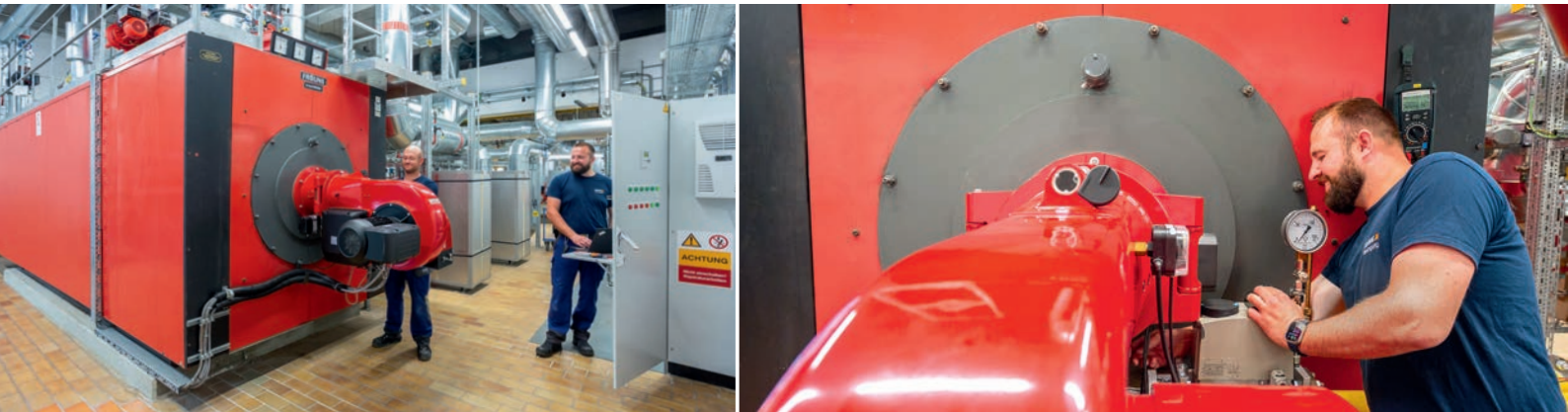
Fernwärme-Heizwerk des Staatstheaters Wiesbaden.
