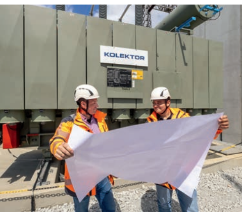
Abnahme, Begutachtung der Kabelführung und Prüfung der Stationsleittechnik des neuen 110-kV-Umspannwerkes in Wiesbaden-Bierstadt.
