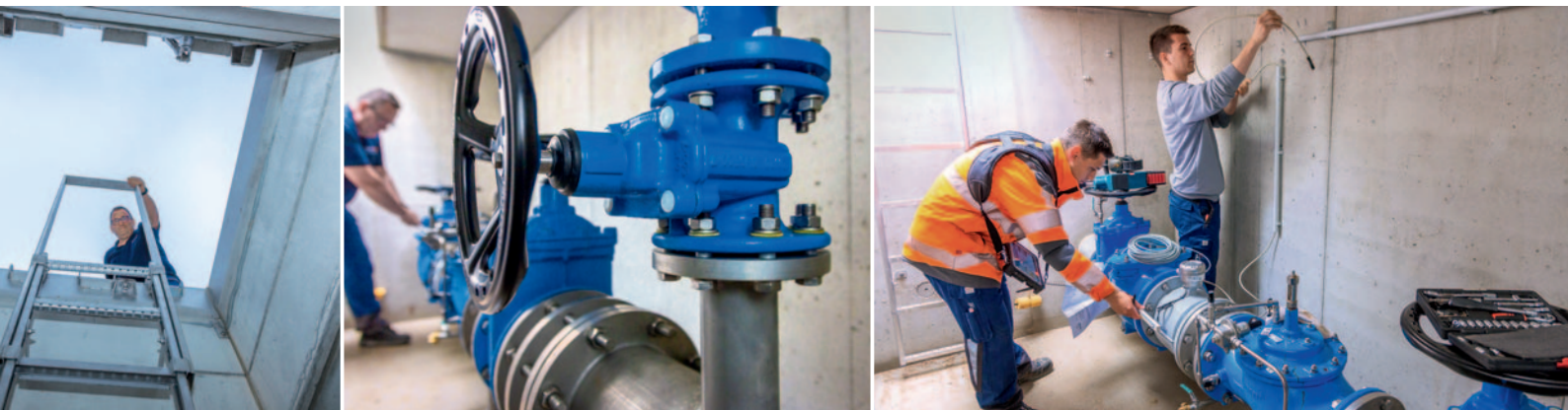
Das neu installierte Druckminder-ventil im Schachtbauwerk in der Weihergasse trägt zur Druckregelung der Wasserzonen in den Stadtteilen Schierstein und Biebrich bei.
