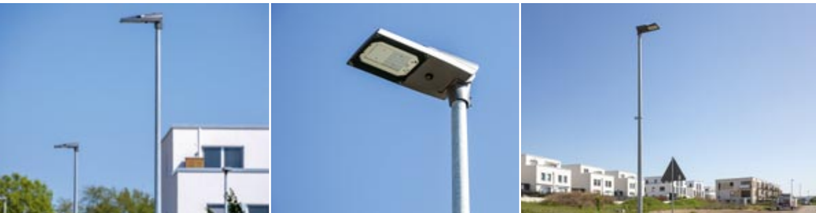
Hocheffiziente LED-Straßenbeleuchtung im Neubaugebiet Wiesbaden-Bierstadt Nord.
