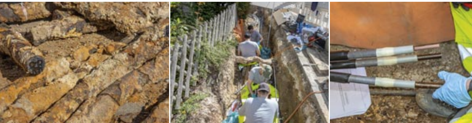
Papierisoliertes 20-kV-Kabel im alten und neuen Zustand.
