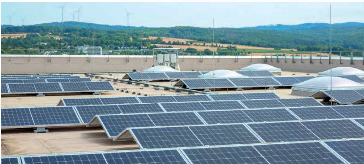
Die Photovoltaikanlage auf dem neuen BRITA-Werk
